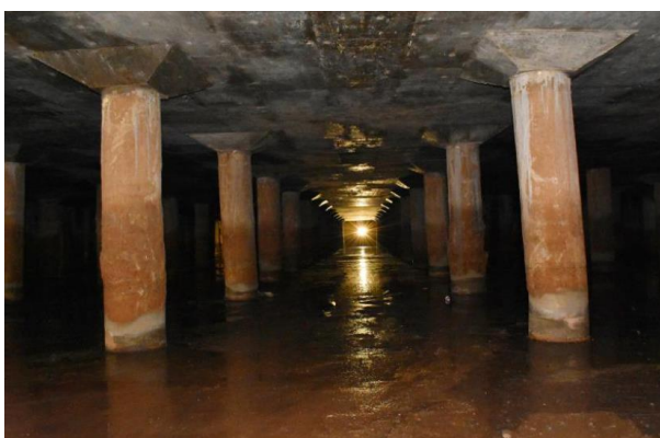
Figura 6 Estanque de retención subterráneo Liceo 26, Montevideo (Fuente: Intendencia de Montevideo).
